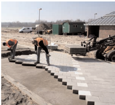
Zunächst erfolgte die Befestigung der Pkw-Bereiche mit VS 5, dann die der Lkw-Flächen.
